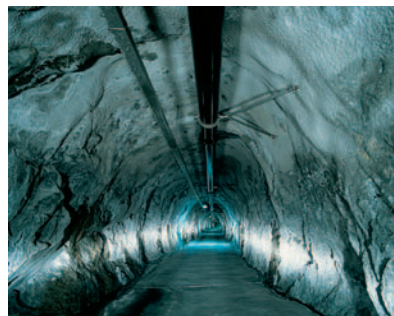
Im Brandfall im Tunnel überzeugen die Gussrohre durch ihre hohe Hitze- und Druckbeständigkeit.
